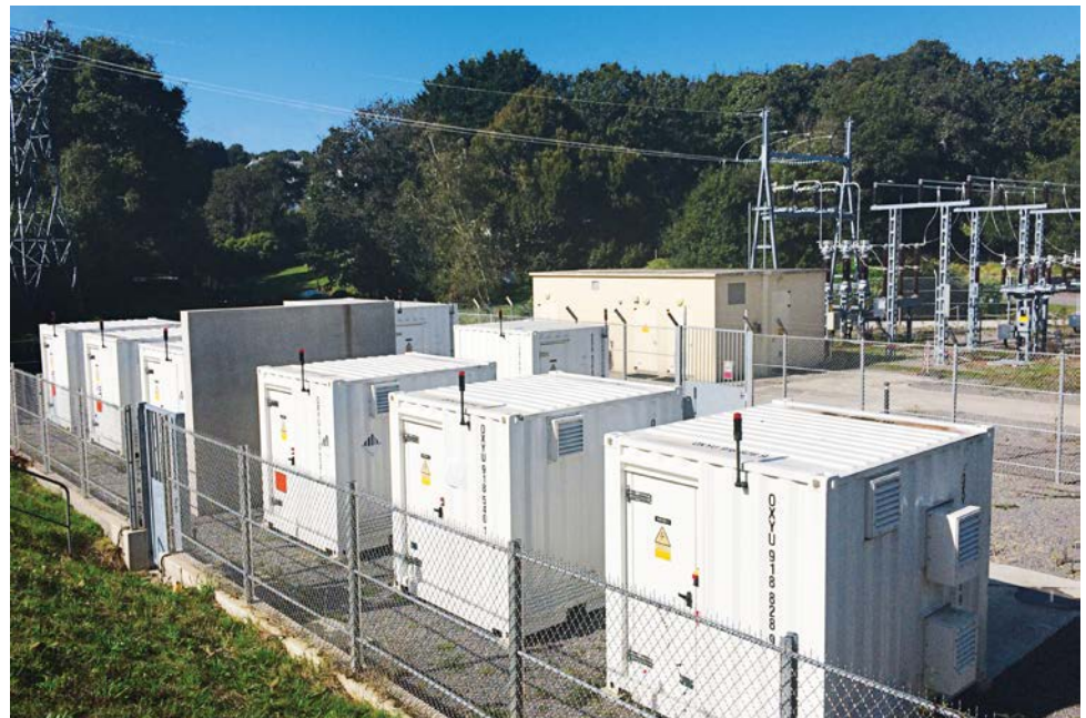
Les packs, grandes surfaces de stockage en vue de l'hébergement des batteries électriques.
